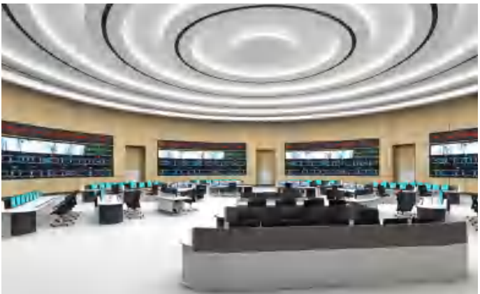
广东佛山地铁 2 号线控制中心
